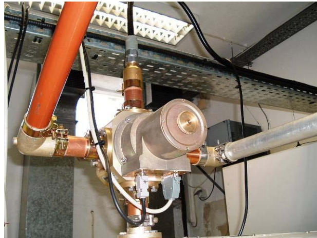
Figura 5. Pormenor de um Comutador de RF que permite endereçar para a baixada da antena, ou excepcionalmente para uma carga 2 , os sinais de RF provenientes do emissor que se encontram em serviço (ou o principal, ou o de reserva).
