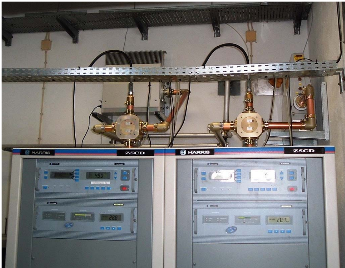
Figura 4. Comutadores de RF e troços de linha rígida (coaxial) com as respectivas uniões, à saída dos andares finais de amplificação de 2 emissores FM de 5 kW.
