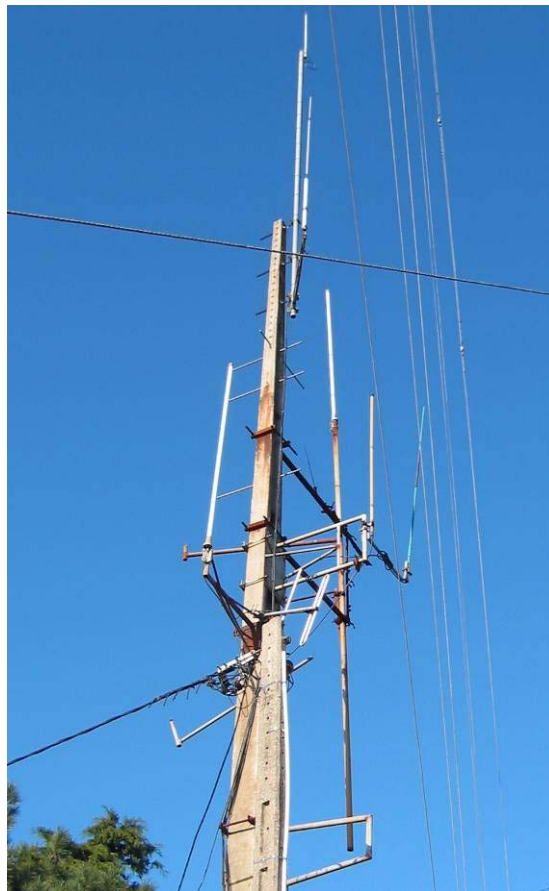
Figura 31. Estruturas de suporte e fixação de antenas corroídas (Santa Eufémia – Sintra).
