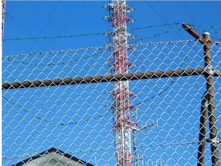
Figura 30. Vedação junto a uma torre de suporte de antenas de emissão de televisão, de elevada potência, apresentando claros sinais de corrosão (Trevim - Serra da Lousã).
