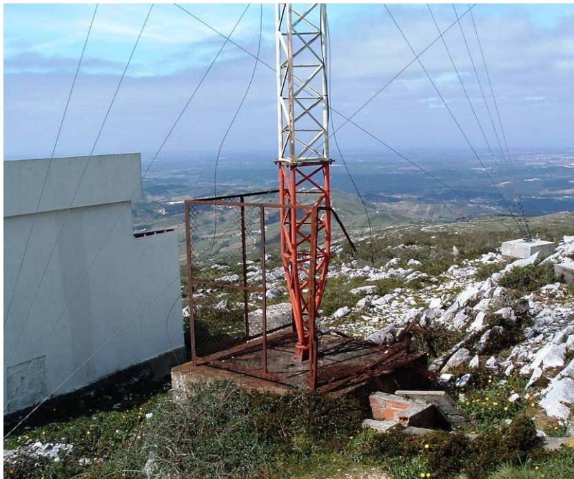
Figura 12. Torre de suporte de antenas abandonada, com a vedação a apresentar corrosão profunda, e espias em mau estado de conservação e até partidas (Serra de Montejunto).
