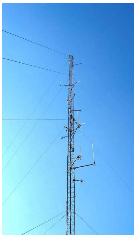
Figura 49. Torre de suporte de antenas do Serviço Móvel Terrestre.
