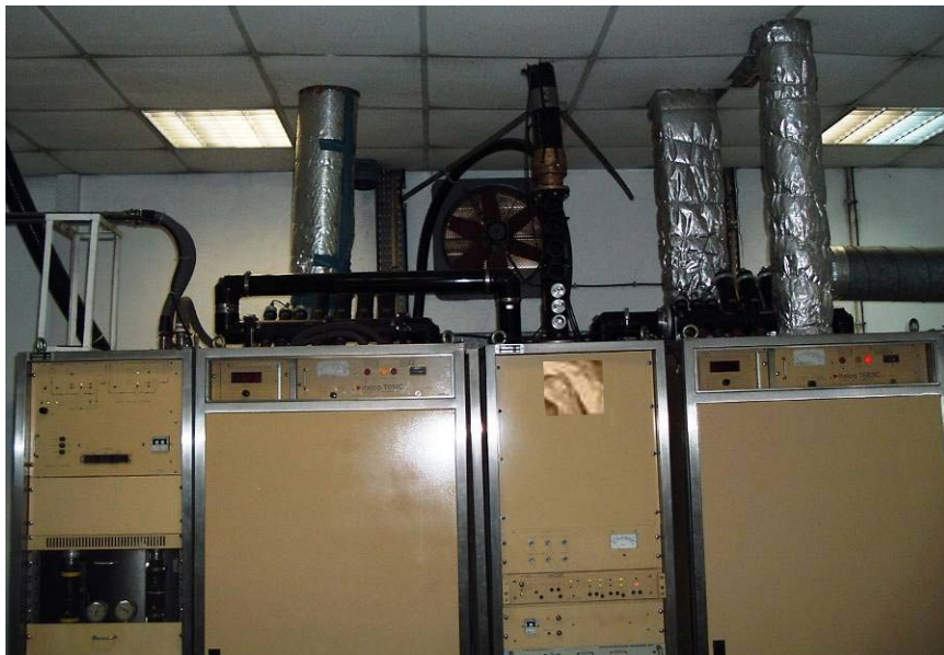
Figura 8. Cabos coaxiais, conectores de RF e acopladores direccionais à saída de um sistema emissor de televisão analógica de 20 kW.
