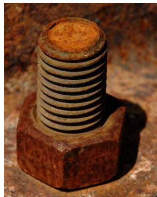
Figura 27. Corrosão num contacto metálico “porca-parafuso”.
